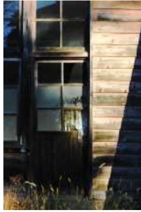
窓が壊れ人がない 影
